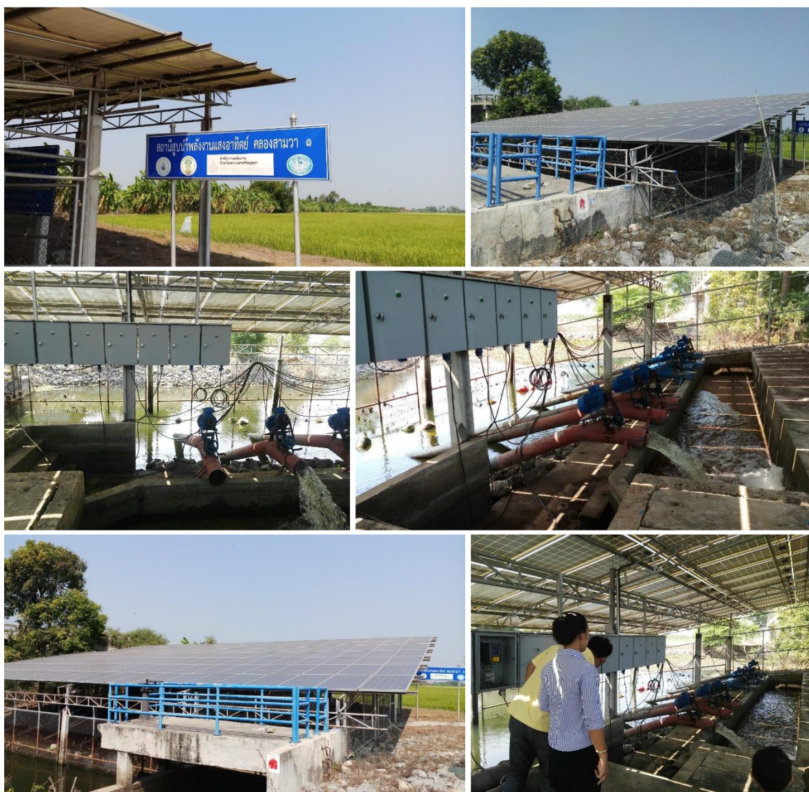
ภาพ 5 สถานีสูบน้ำพลังแสงอาทิตย์
